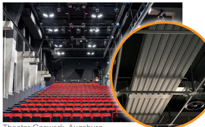
Theater Gaswerk, Augsburg Deckenstrahlplatten ECO EVO Plus in Sonderfarbe
